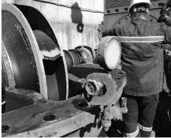
Resim 4. Pompanın Seramik Kaplama Öncesindeki Durumu
